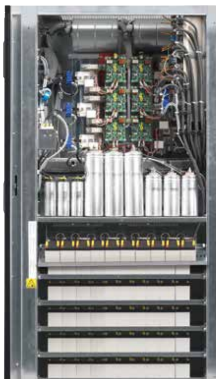
EQUIPAGGIAMENTO BATTERIE INTERNE
